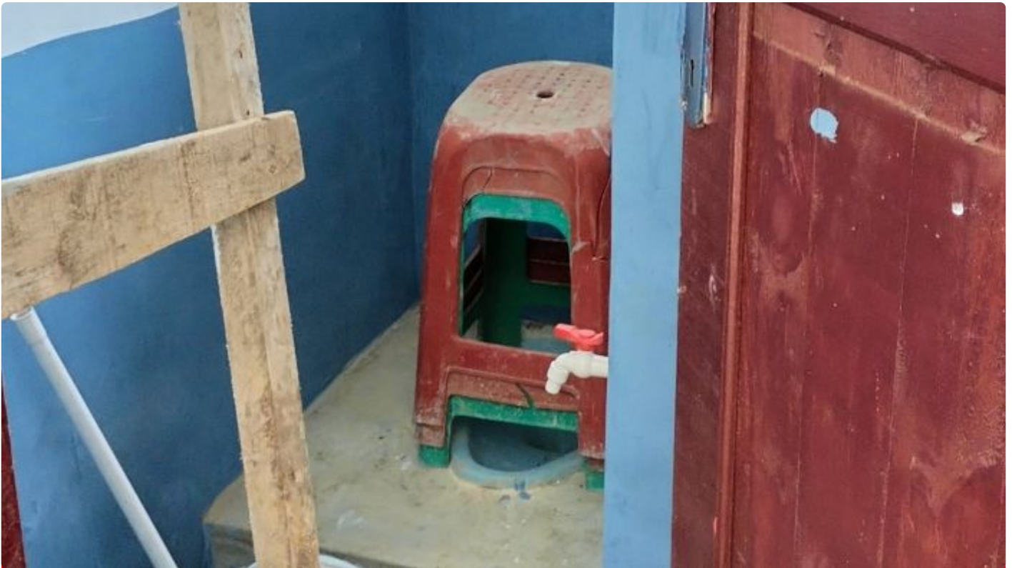
Kondisi toilet (jamban) SMPN Satap 1 Dolat Rakyat, Kecamatan Dolat Rakyat, Kabupaten Karo seharga Rp.169 juta
