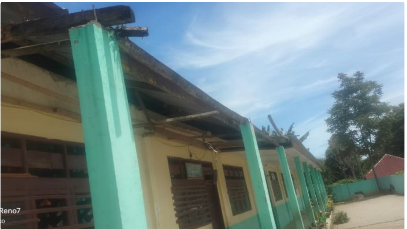
Perbaikan Teras SD Inpres Lingga, Kecamatan Simpang Empat, Kabupaten Karo yang mangkrak
